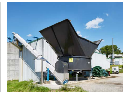
Offene Übergabe auf bestehendes Fördersystem
