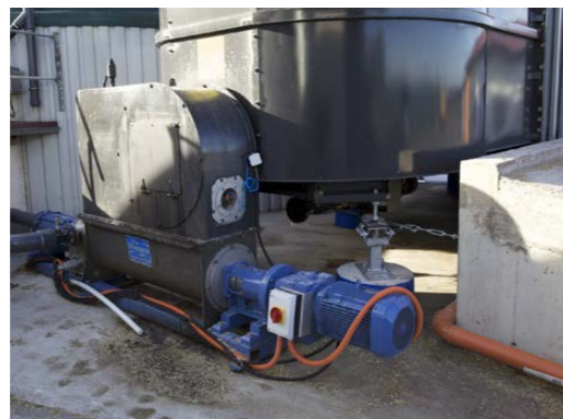
Fördertechnik: direkte Übergabe auf Wangen-Biomix-Pumpe
