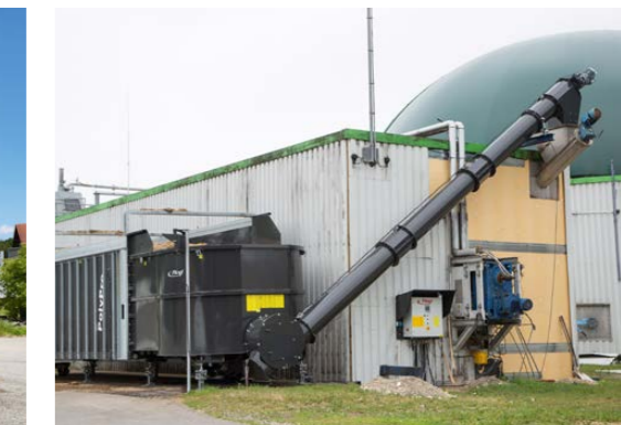
Hochförderschnecke mehrfach zwischengelagert mit PE-Halbschalen
